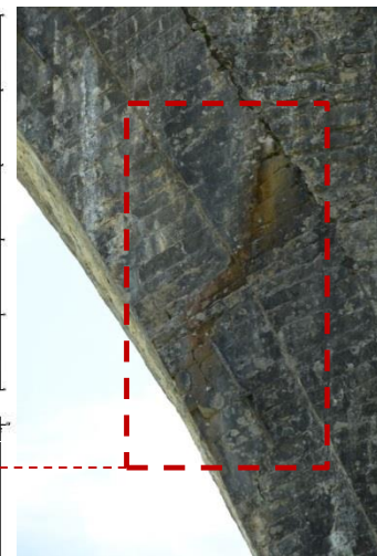
ρωγμή στη θέση αλλαγής πλάτους (όψη από ανάντη)
