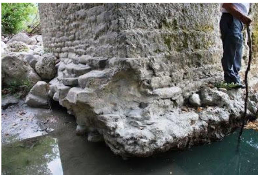
Εικ. 11. Βάση του αριστερού βάρου της γέφυρας (βορειοδυτική γωνία) σε παλαιότερη περίοδο χαμηλών υδάτων. Φαίνεται η έντονη διάβρωση του βάρου και η υποσκαφή της θεμελίωσης.
