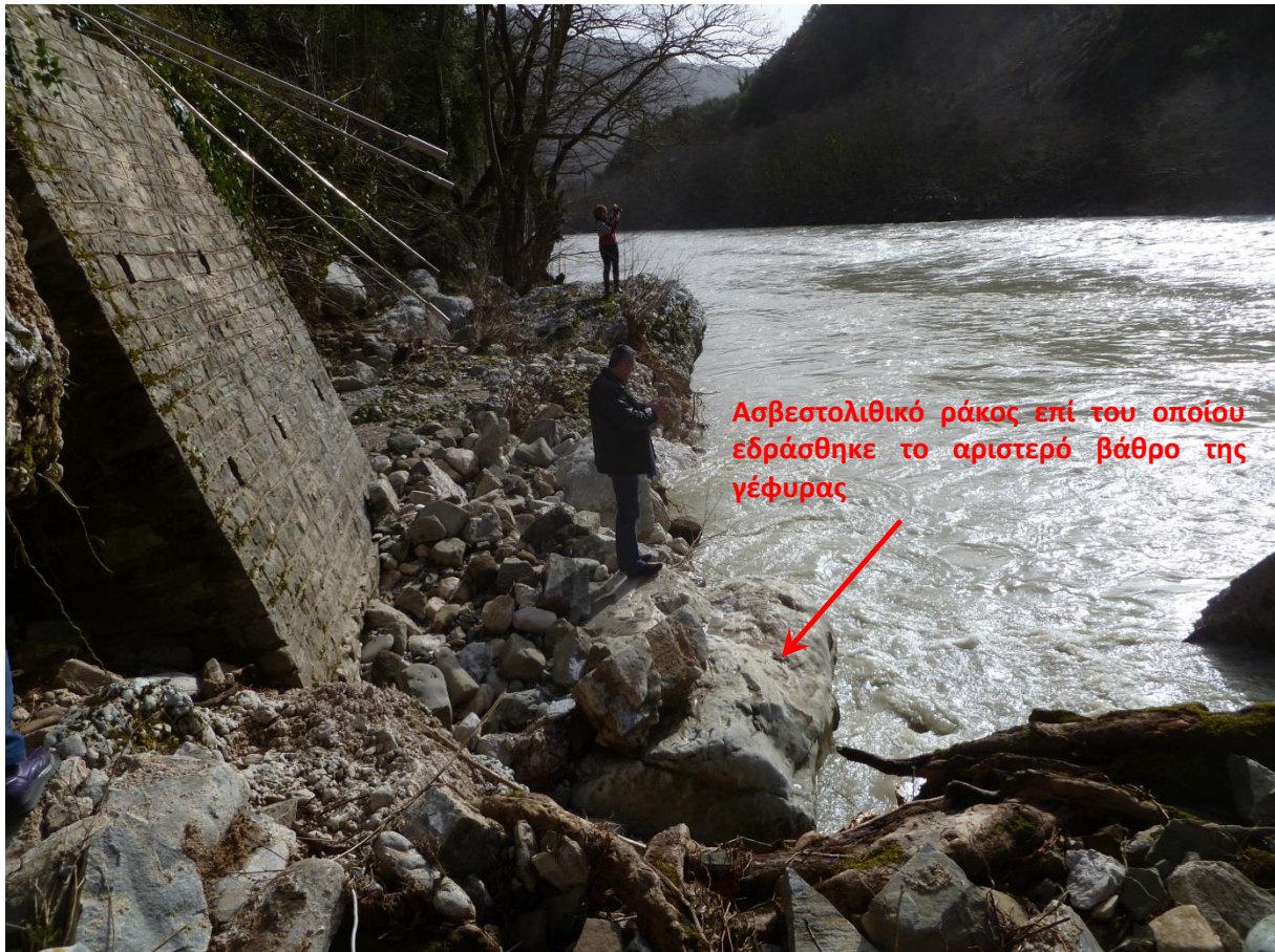
Εικ. 9. Άποψη (από ανάντη) της βάσης της αριστερής πλευράς του αριστερού ανακουφιστικού παραθύρου, μετά την κατάρρευση της γέφυρας. Η βάση του αριστερού βάθρου της γέφυρας βρισκόταν στο δεξί άκρο της φωτογραφίας, κάτω από τη στάθμη του νερού (το πλάτος της βάσης του παραθύρου ήταν περίπου 4 μέτρα). Δυστυχώς, η έδραση του βάθρου που κατέρρευσε δεν κατέστη δυνατόν να επιθεωρηθεί, καθώς την ημέρα της αυτοψίας η στάθμη του ποταμού ήταν υψηλή. Στο κέντρο της φωτογραφίας φαίνεται ο (λευκός) ασβεστόλιθος (επί του οποίου στέκεται ο άνθρωπος), δεξιά του οποίου εδραζόταν το βάθρο της γέφυρας. Σημειώνεται ότι αυτός ο ασβεστόλιθος δεν είναι συνεχής σχηματισμός, αλλά απλώς ένας ογκόλιθος (ασβεστολιθικό ράκος) περιορισμένων διαστάσεων επί του φλύσχη. Δεν υπάρχουν στοιχεία για το μέγεθος του συγκεκριμένου ογκολίθου, αλλά θεωρείται πρακτικώς βέβαιον ότι οι τεχνίτες της εποχής θεμελίωσαν το αριστερό βάθρο στη συγκεκριμένη θέση λόγω της παρουσίας αυτού του ασβεστολιθικού ογκολίθου.
