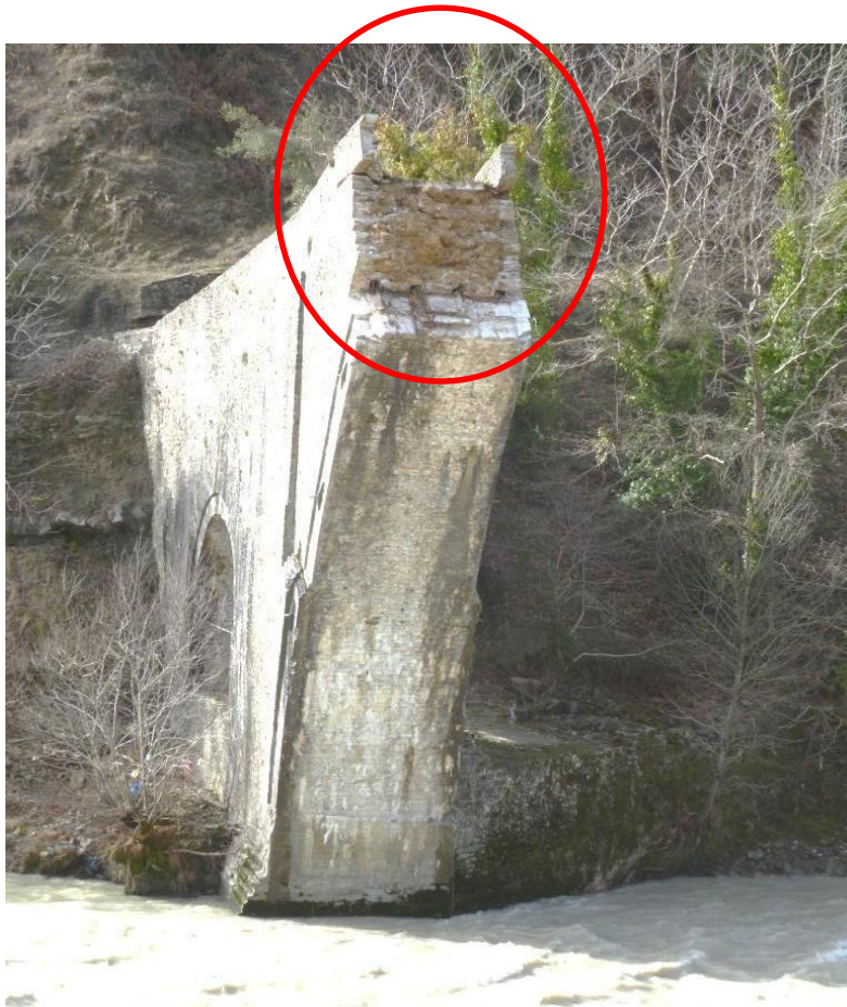
Εικ. 14. Άποψη του δεξιού ακροβάθρου μετά την κατάρρευση. Μεταξύ του κεντρικού τόξου και των τυμπάνων του, υπάρχει μια περιοχή υλικού πληρώσεως, το οποίο μοιάζει να αποτελείται από μικρούς λίθους και χώμα.
